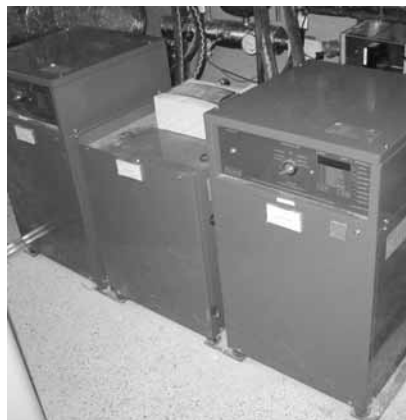
Abb. 7: Die drei Wärmepumpen mit 3,4 \text{ kW} (2x) und 1,4 \text{ kW} (1x) elektrischer Anschlussleistung
