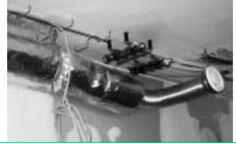
Abb. 7: Luftabsaugung mit Schalldämpfer sowie Hydraulikgruppe der Betonkerntemperierung in einem Büroraum (vor der Verkleidung).
