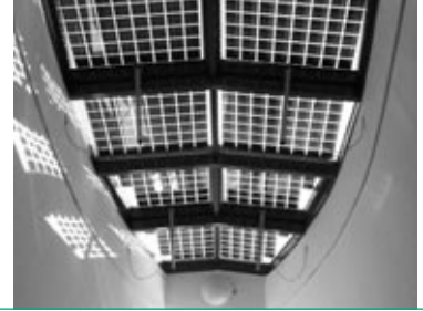
Abb. 4: Solarstromanlagen als Bestandteil der Dachverglasung der Atrien in den Bürotrakten
