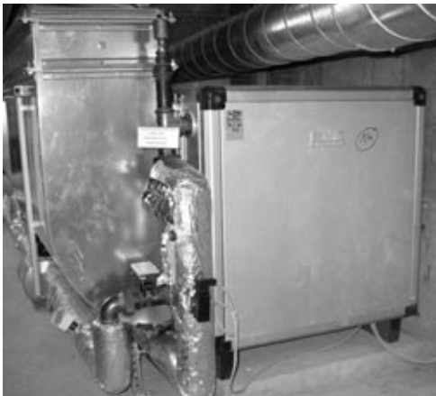
Abb. 5: Eine der Abluftwärmepumpen
