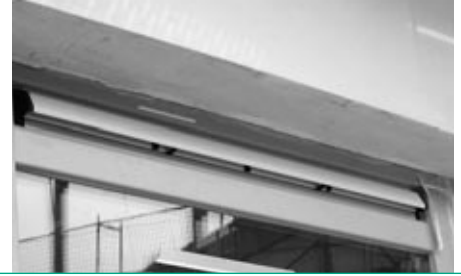
Abb. 8: Durch Präsenzmelder gesteuerte Zuluftelemente oberhalb der Bürofenster
