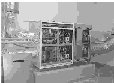
Abb. 8: Lüftungsgerät mit integrierter Wärmepumpe zum Heizen und Kühlen
